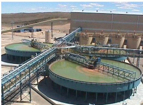
Figura 3.1: Espesadores Elevados de Acero Durante la Operación
